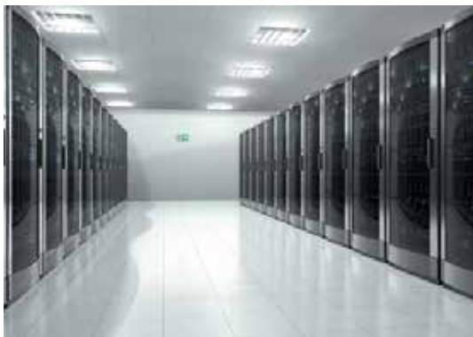
Fig.3 Intérieur de la salle des serveurs © Scanrail – Fotolia
